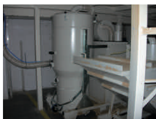
Instalación hecha en una industria agroalimentaria.
