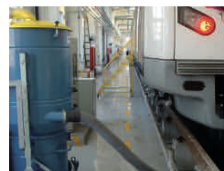
Instalación hecha para limpieza de trenes.
